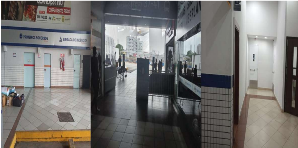
Figuras 26, 27, 28. Falta de sinalização de emergência no Terminal Rodoviário de Goiânia.
