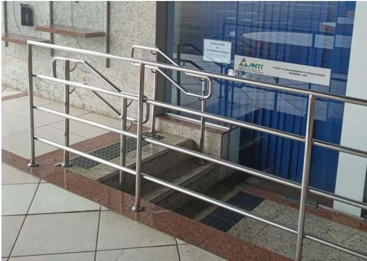
Figura 31. Sinalização de degraus isolados
